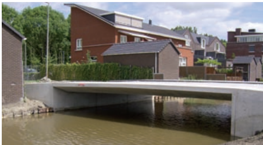
Kroeze Aannemersbedrijf voert in samenwerking met Kroeze Betonbouw de aanleg van vijf betonbruggen uit in Rotterdam.
